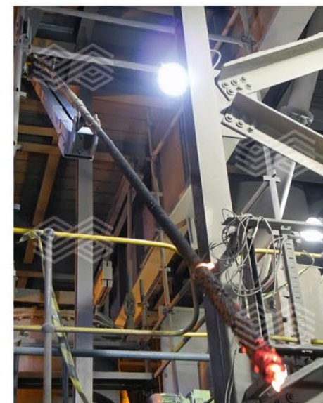
6本電極炉に据付けられた全自動 EMLI-FurnaceProfileシステム
